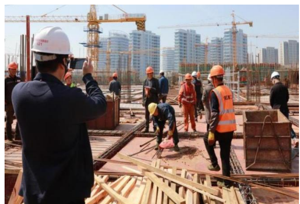
之江新馆建设期间，我馆工作人员在现场跟踪督促精装修与设备安装
